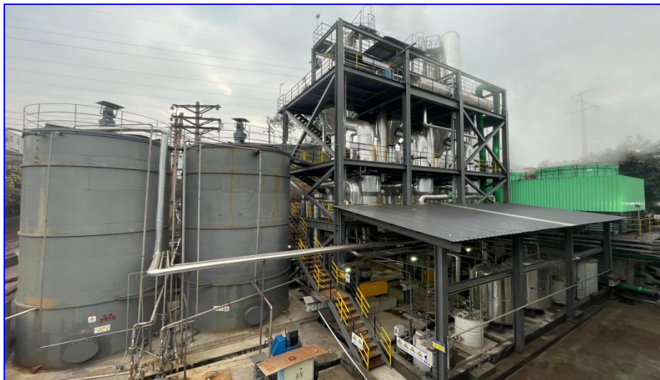
图 烧结机 38m 3 /h 脱硫废水综合处理利用项目
