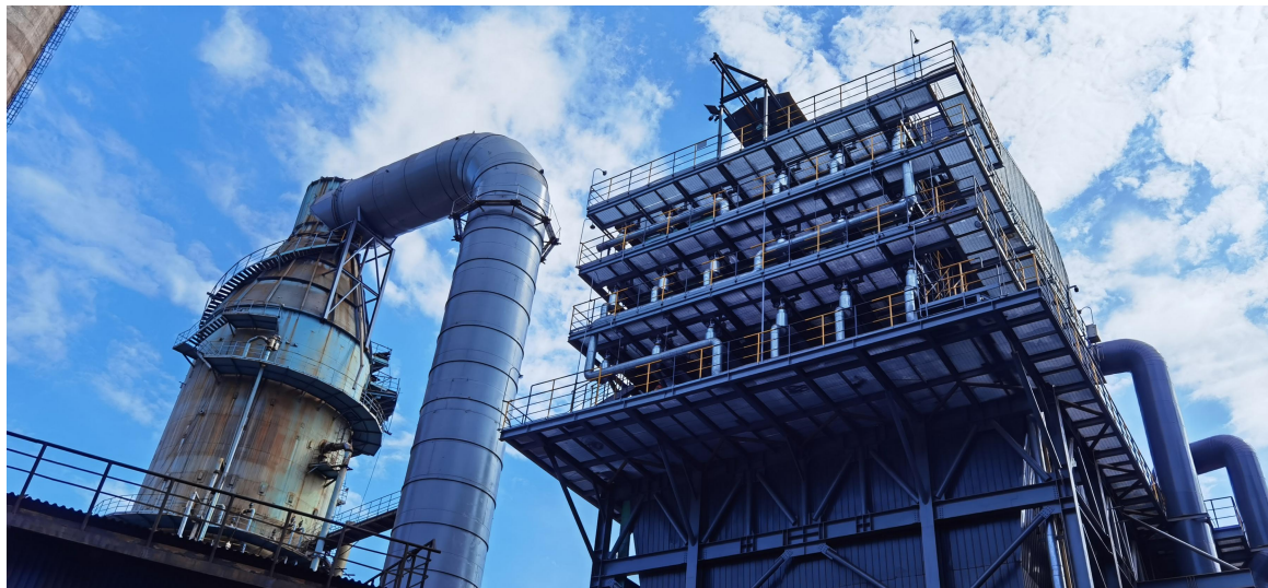
改造完成的新 3 号烧结烟气脱硝装置
