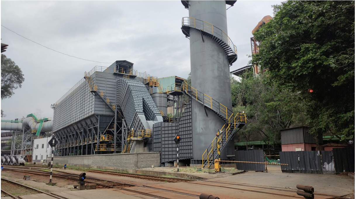
改造完成的 6、7 号转炉二次除尘装置
